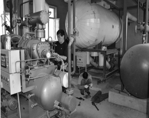
吉林省亚亨农牧科技发展有限公司目前已建成年屠宰20万只肉羊屠宰线,冷库面积1000平方米,羊肉精深加工车间面积500平方米。预计今年11月份可投入生产。图为公司科技人员正在对生产设备进行检测、调试。 李岩峰摄
