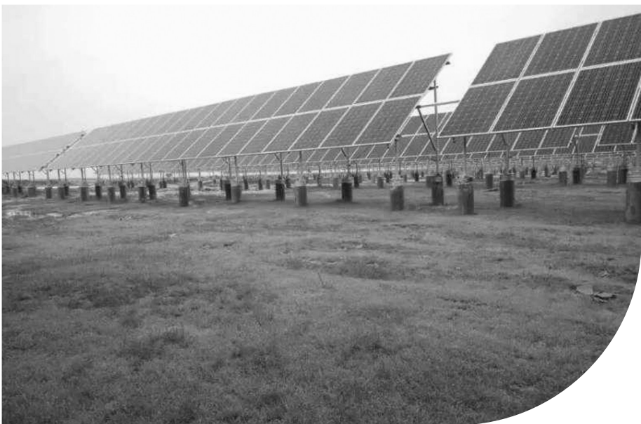
通榆天宏虹辉10MW光伏发电项目电站产区光伏组件
