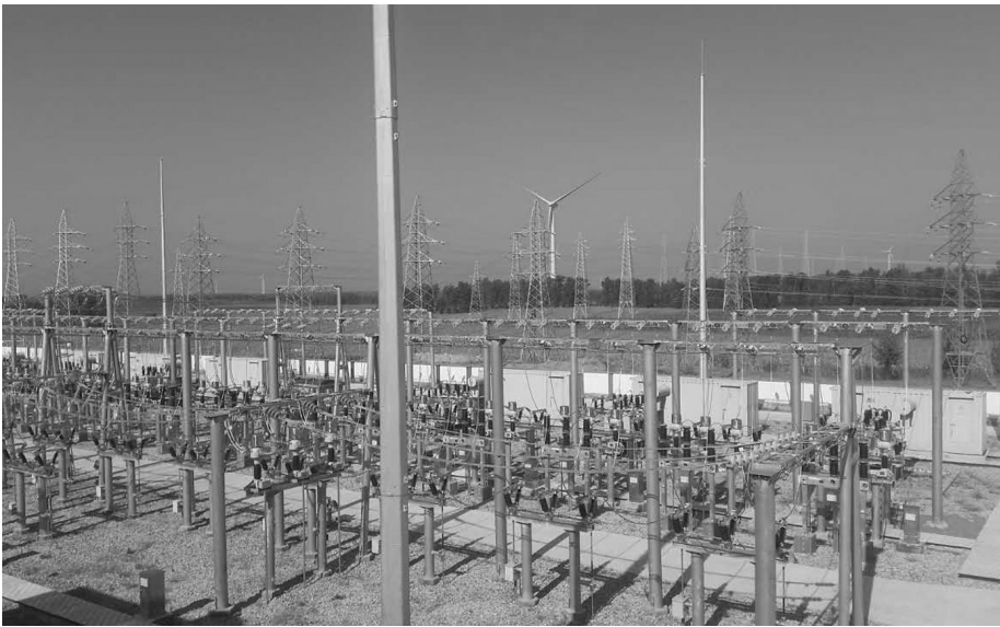
华能新华风电场变电站
