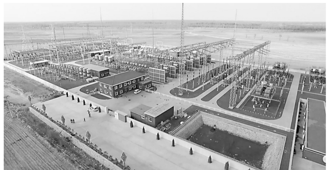
运转良好的瞻岭500千伏输电变电站。
