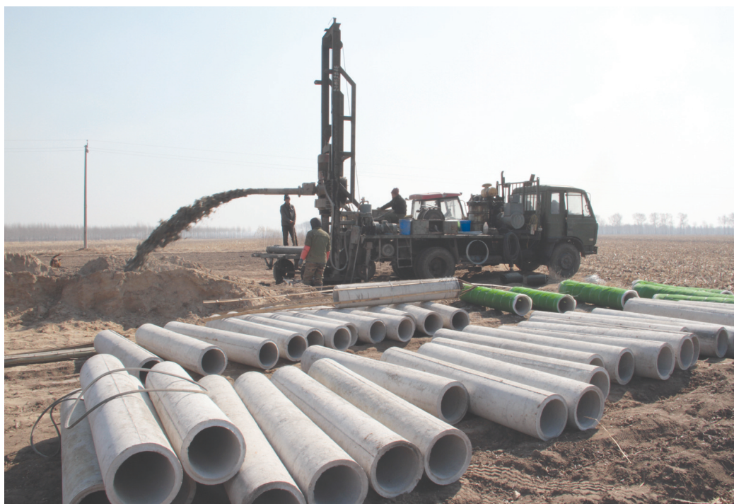
春耕生产已经开始,镇赉县发改、农业、水利等部门迅速启动抗旱井工程,助力脱贫攻坚,确保农业增产增收。图为镇赉县五棵河镇“千斤粮食灌溉井工程”大型机电井施工现场。潘晟昱 张景宽摄
