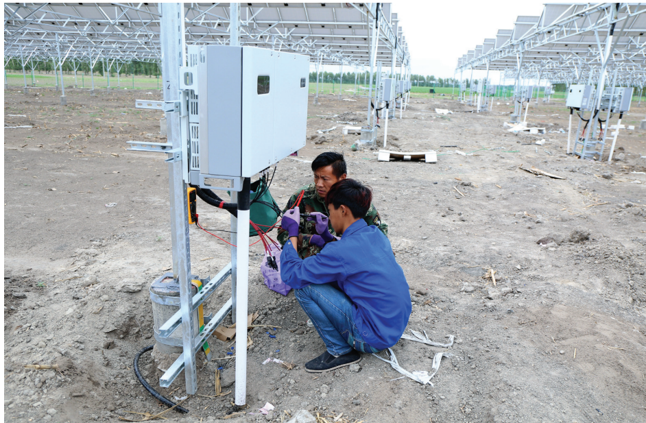
洮北区到保镇到保村光伏扶贫电站近日并网发电。电站装机容量1.5兆瓦,占地面积3.4公顷,总投资1125万元,年发电总量约为225万千瓦时,年总收益约198万元,每个贫困村将得到不少于30万元的收益。图为工作人员正在调试设备。 本报记者马彬摄
