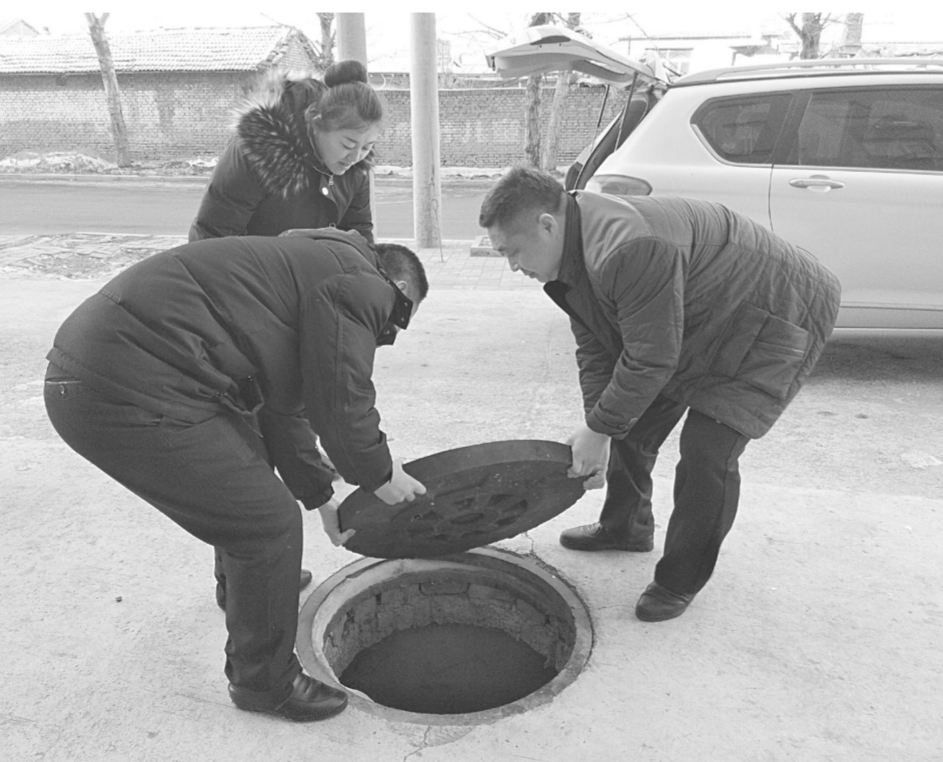
前不久,洮南市富文街道富强社区“五老”治安巡逻队员在对辖区内安全隐患进行排查时,发现帅府小区和新农电小区下水井盖共有6处破损,给小区居民出行带来了很大的安全隐患,他们及时向社区报告了情况。社区领导了解情况后,立即上报办事处并申请为小区更换井盖。目前,两个小区所有破损井盖已更换完毕,确保了居民出行安全。李丹丹摄
