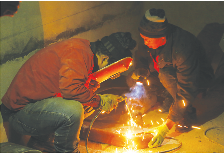
市区隆兴公馆地下室管道漏水,京科集中供热有限公司检修班迅速接单抢修。 本报记者王野村摄
