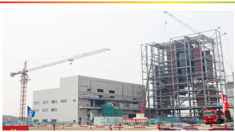
建设中的通榆县善能新能源有限公司30MW生物质热电联产项目。本报记者段卫军摄
