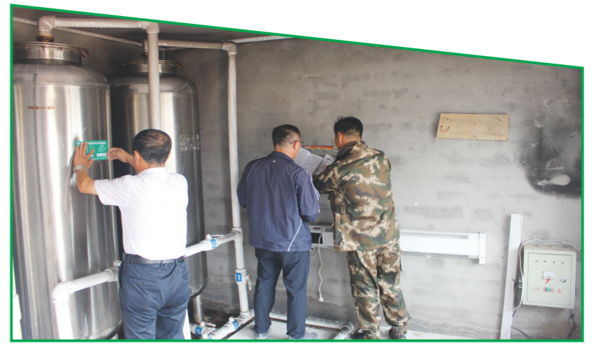
水利部门工作人员进行饮水安全工程水处理设备冲洗的督查排查工作。
