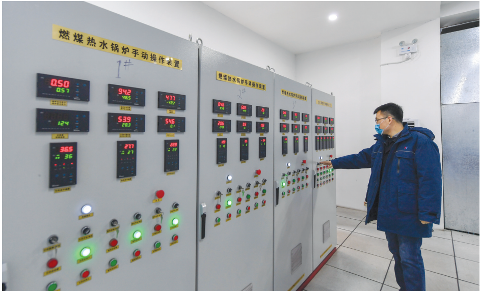
1月6日,在长春市热力(集团)有限责任公司东岭事业部,工作人员在调整供热系统运行参数。
