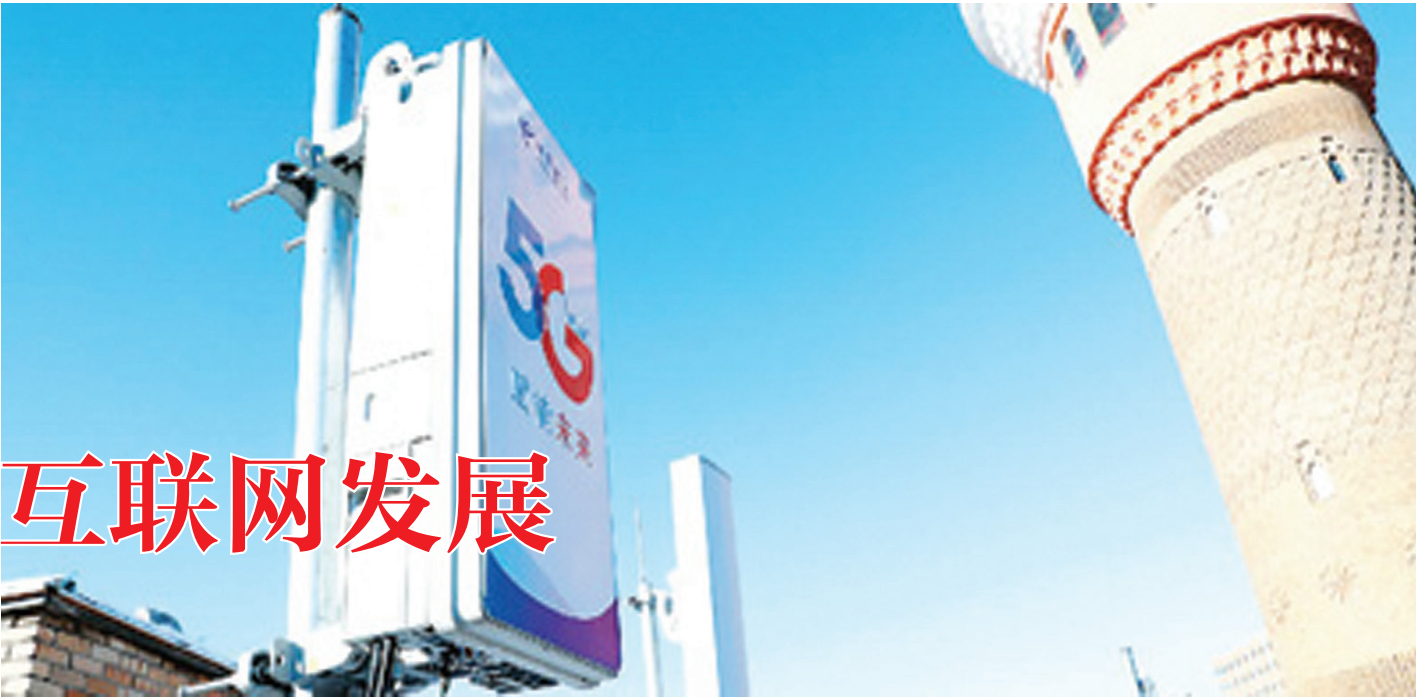
新疆乌鲁木齐国际大巴扎景区房顶上的5G基站。
