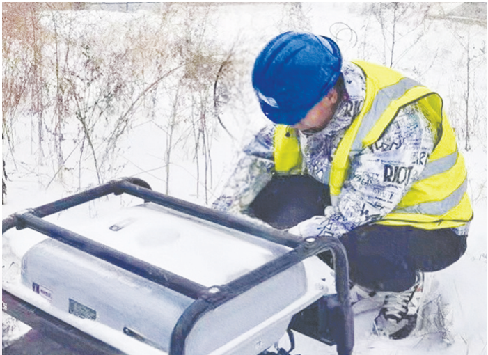
图为维护人员利用发电机对基站进行供电保障。 罗静霖摄
