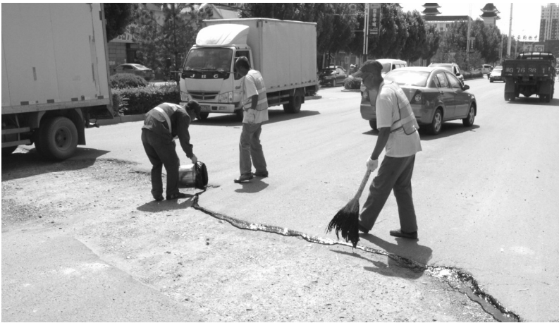
修复之前的破损路面。
