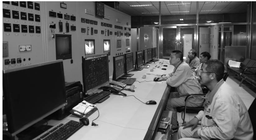
众合生物质能热电厂主控室。
