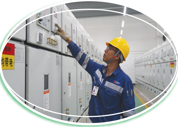
吉电股份白城发电公司发电部机组长于志强正在查看1C空冷变压器高压侧开关运行参数。 本报记者张殿文摄
